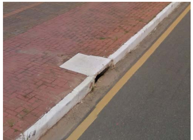
Figura 32 Boca-de-lobo com abertura na guia
