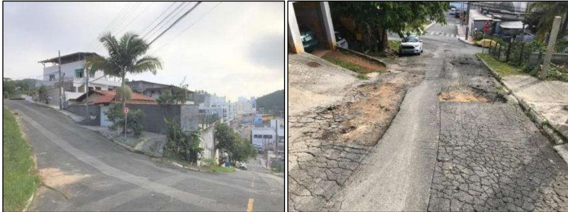
Figura 279 – Visão da rua Coleirinha (esquerda) e pavimento danificado (direita).
