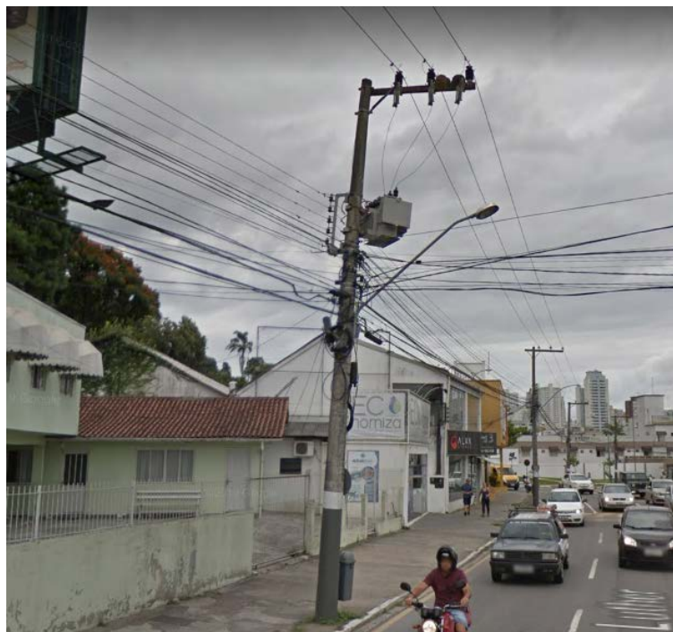
Figura 12 - PR05 – Poste da CELESC relocado por estar em cima da pista projetada
