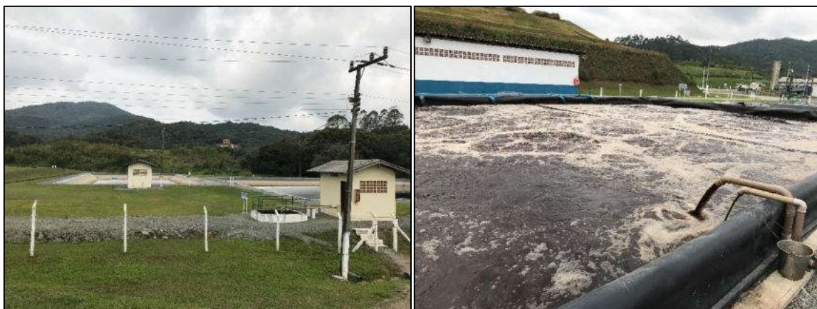
Figura 389 – Sistema de tratamento do chorume.
