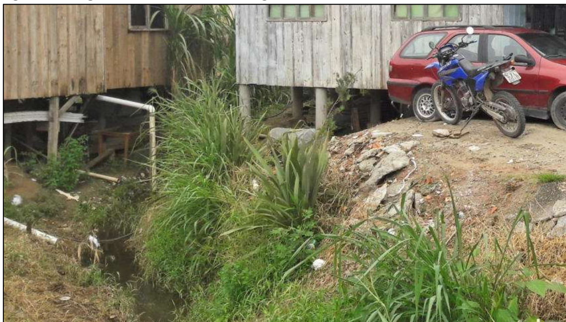
Figura 404 - Esgotamento doméstico em córrego no loteamento Vila Fortaleza.
