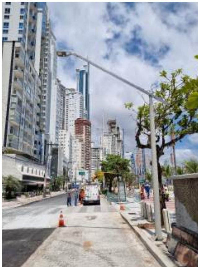
Detalhes do poste via
