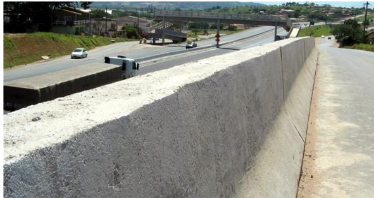
Figura 14.8 - Barreira New Jersey
