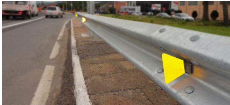
Figura 14.4 - Refletivos para defesa metálica
