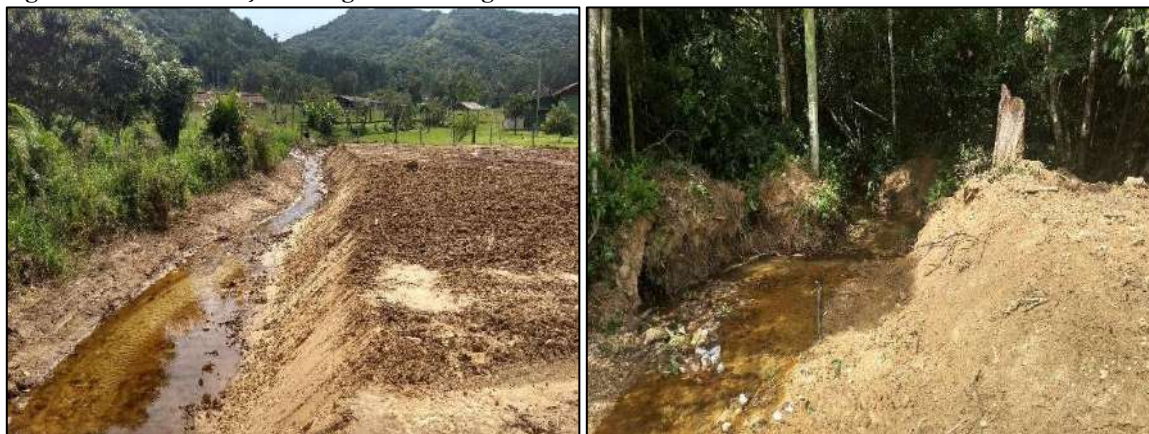
Figura 114 – Intervenção irregular às margens do Rio Canhanduba.
