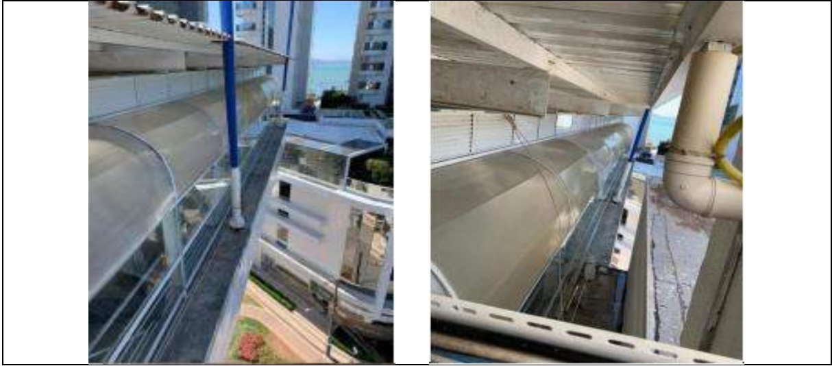
Figura 4 – Risco 03: Chapas acrílicas com risco de queda.
