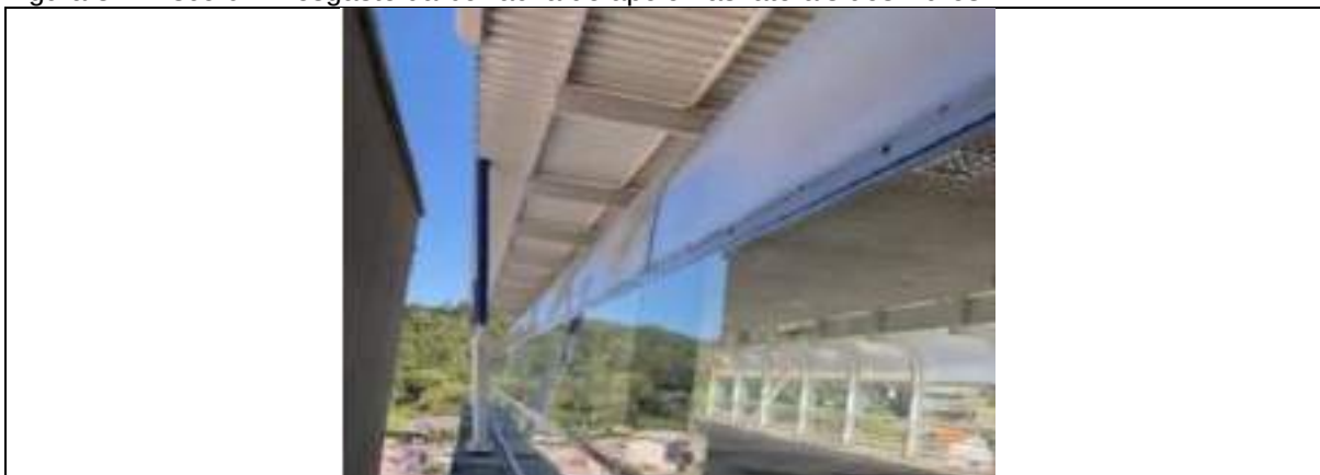
Figura 3 – Risco 02: Desgaste da borracha de apoio nas laterais dos vidros.
