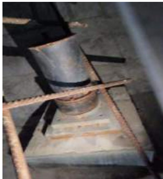
OUTRA ANCORAGEM FIXA APRESENTANDO FORTES SINAIS DE OXIDAÇÃO DO CAPÔ
