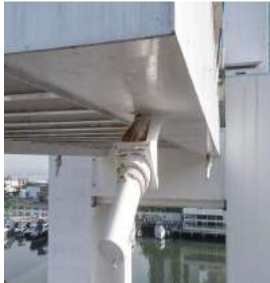
ANCORAGEM MÓVEL E5-JUSANTE-P2 BARRA NESSA ANCORAGEM VEMOS TAMBÉM QUE A OXIDAÇÃO ESTÁ ATVA NO TUBO FORMA E MENOS NO CAPÔ.
