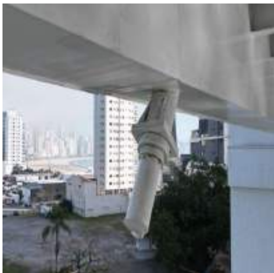
ANCORAGEM MÓVEL E1-MONTANTE P1 IATE NESSA ANCORAGEM VEMOS QUE PRÁTICAMENTE NÃO HÁ OXIDAÇÃO, NEM NO CAPÔ NEM NO TUBO FORMA.
