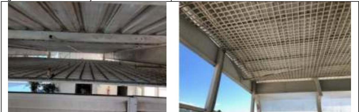
Figura 6 – Risco 05: Fixação do forro corroída e parte dele se soltando.
