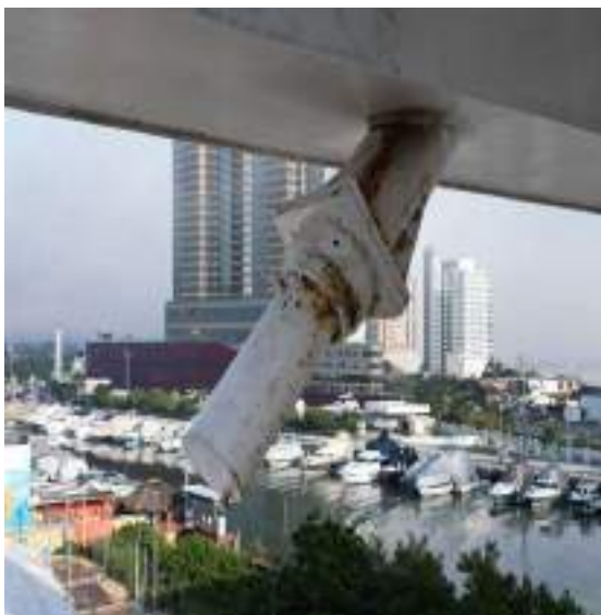
ANCORAGEM MÓVEL E5-MONTANTE P2 BARRA NESSA ANCORAGEM VEMOS QUE EXISTE OXIDAÇÃO ATIVA TANTO NA PARTE SUPERIOR DO TUBO FORMA, COMO TAMBÉM NO CAPÔ.
