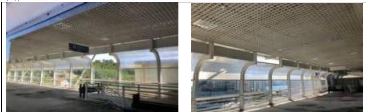
Figura 8 – Risco 09: Queda de peças de grande altura. Acrílico lateral e Veneziana arrancados pelo vento.
