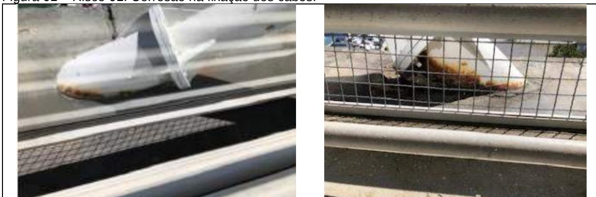
Figura 01 – Risco 01: Corrosão na fixação dos cabos.
