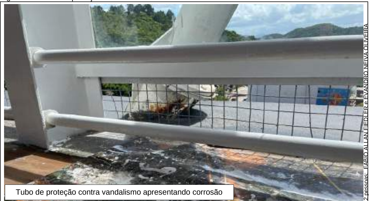
Figura 16 – Tubo de proteção contra vandalismo
