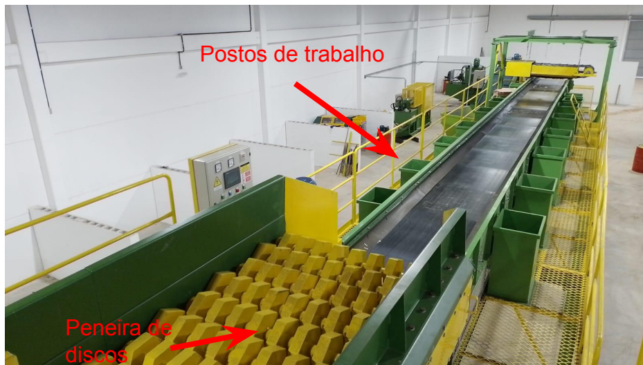
Figura 06: Esteira de triagem com 16 postos de trabalho.
